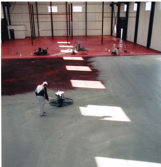
Vista de una nave con una zona ya fratasada al fondo, otra con el premezclado espolvoreado humectándose y otra con el lecho de hormigón.
