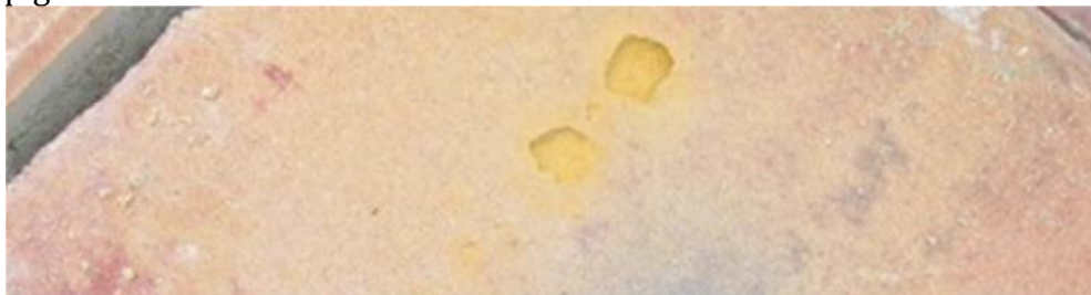
FIGURA 7. Defecto en la superficie de un adoquín por presencia de bolitas de pigmento.
